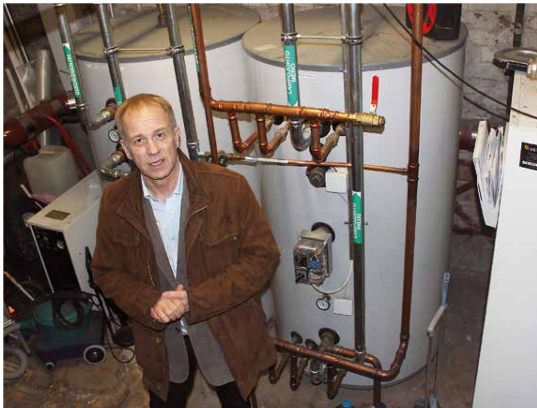
Maalämpöpumppu saatiin sijoitettua tilaan, jossa sijaitisivat ennen talon lämpökattilat. – Laitteisto mahtui hyvin vanhaan pannuhuoneeseen, sanoo hallituksen puheenjohtaja Jari Kajas.
