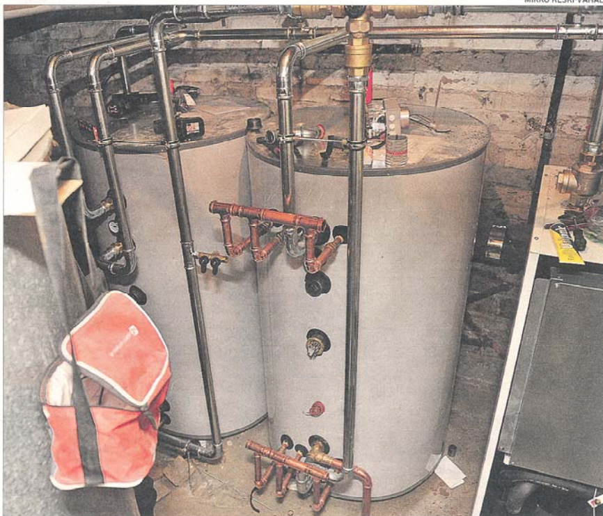
Kivelänkatu 1 b:n päättös siirtyä maalämpöön on herättänyt mielenkiintoa muussakin taloyhtiössä.
